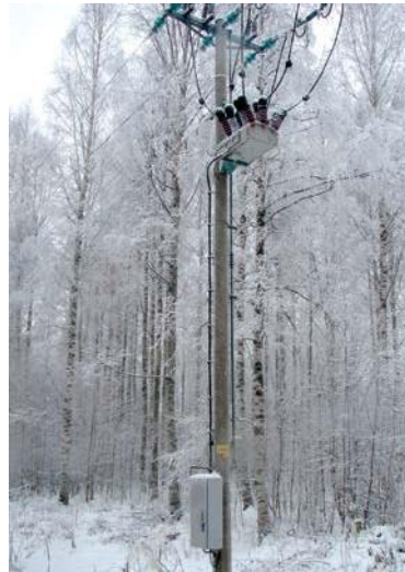
RESTAURADOR OSM Y CUBÍCULO DE CONTROL Y COMUNICACIONES RC
